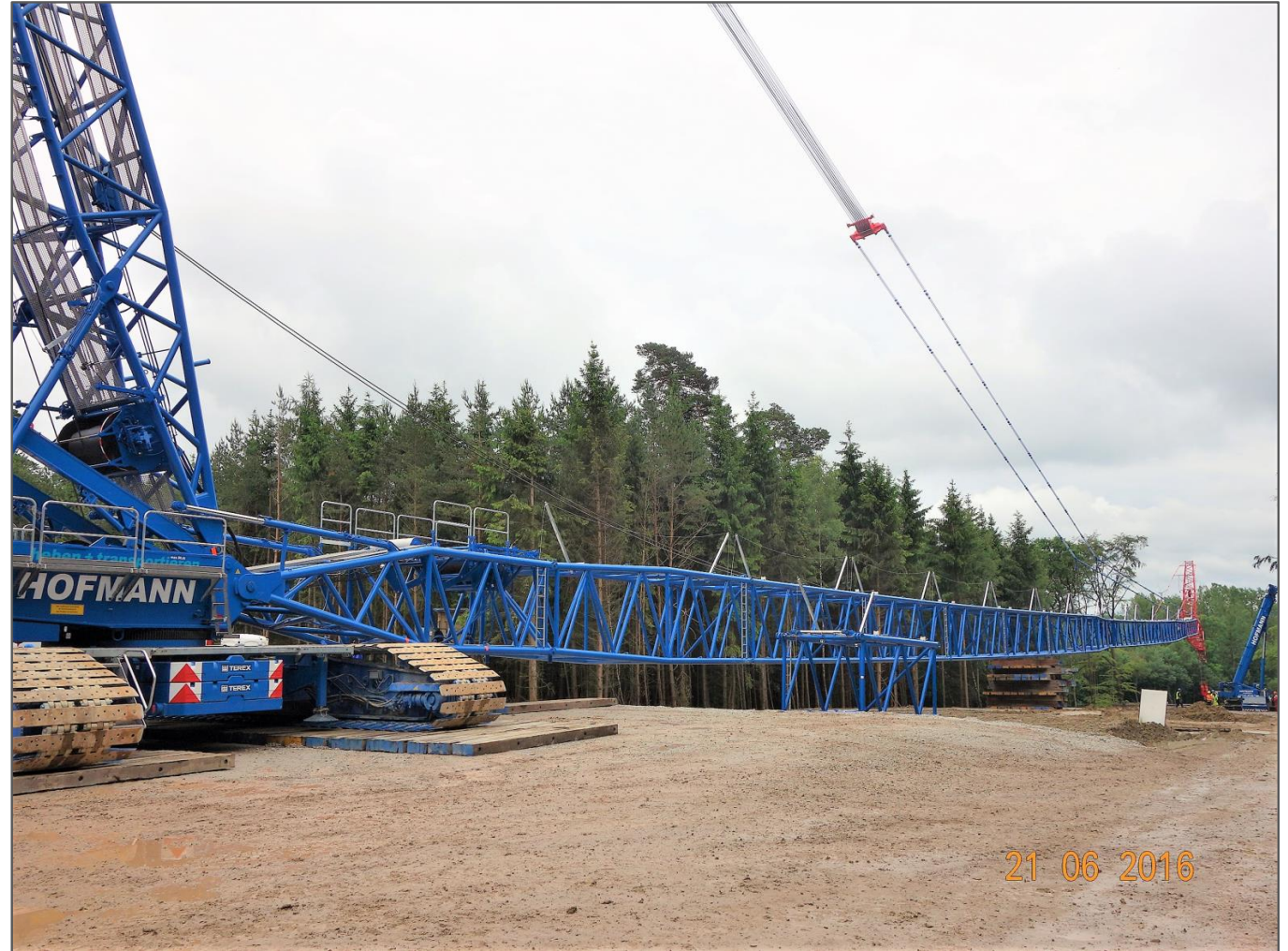
Abb. 12: Kranausleger (180 m) beim Bau einer Nordex N131 mit 164 m Nabenhöhe in Bickenbach
